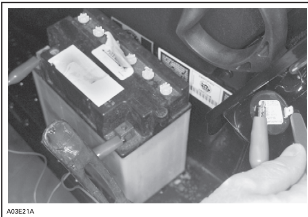
BATTERIE DE 12 VOLTS BRANCHÉE À L'AVERTISSEUR
